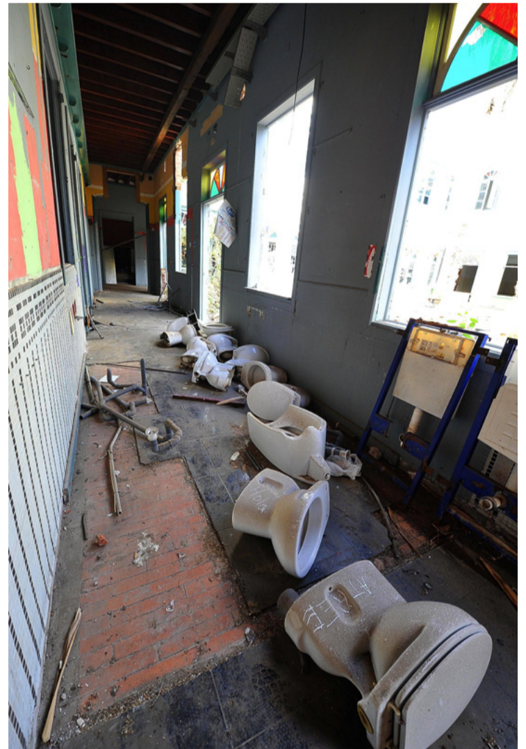
Algunas zonas del interior de la casa presentan un aspecto lamentable.
