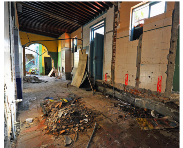
Las obras inacabadas se mezclan con destrozos.
